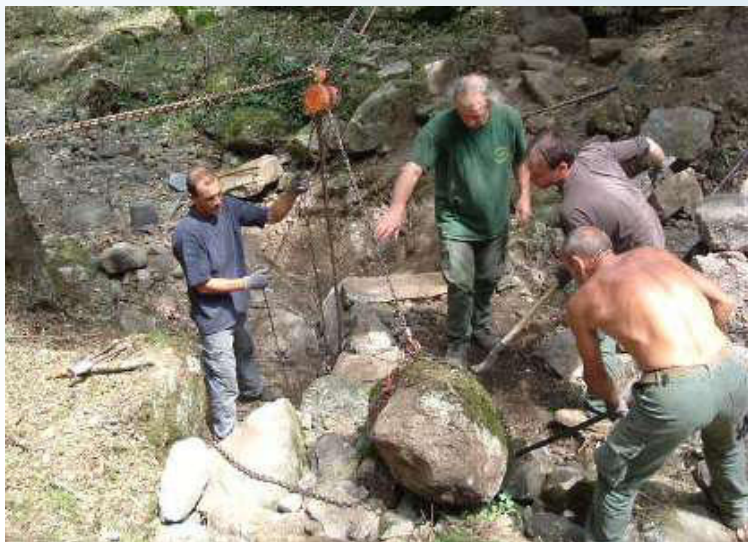
Photo 1 - Manipulation d'un bloc sur le chantier de réhabilitation des tancats . (cliché : J.F. DIDON- LESCOT)
