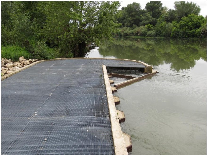
Prise d'eau de la passe à poissons et la drome déflecteur
