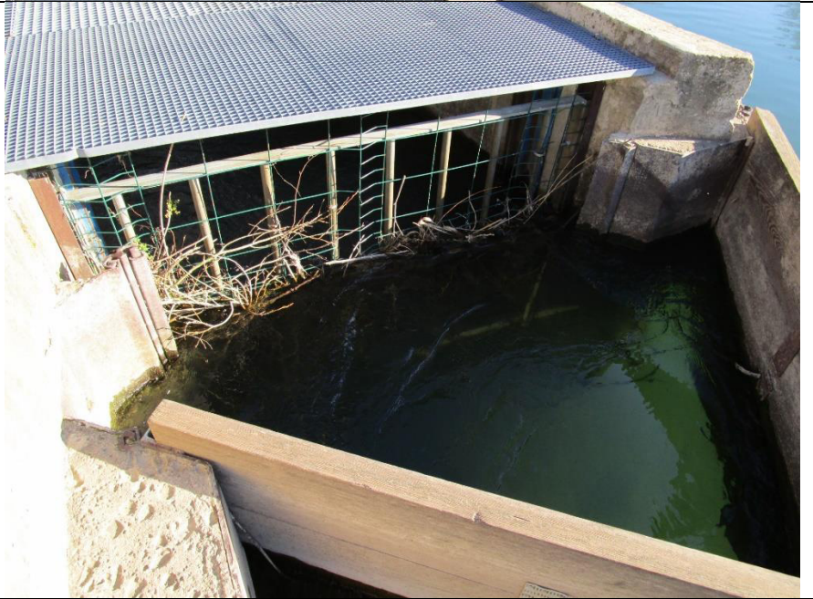
Dispositif de protection de la prise d'eau
