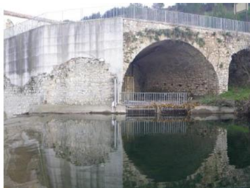
Figure 4 : Prise du canal de Boucoiran (SMAGE des Gardons, Egis Eau, 2012)
